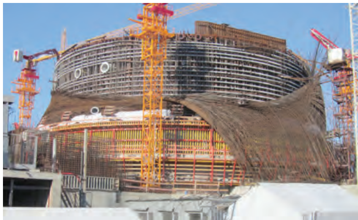
[Рис. 2. Обвал арматуры на строящейся ЛАЭС-2 17 июля 2011 г.]
